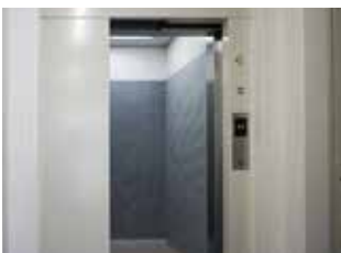
エレベーター
