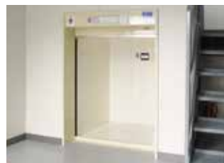
荷物用エレベーター
